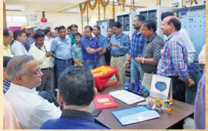
आकाशवाणी कटक में विविध भारती एफएम के 10 किलोवाट एवं एफएम रेनबो के 6 किलोवाट के ट्रांसमीटरों की कमीशनिंग
